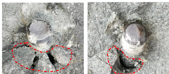
(a) 混凝土挤压破碎
